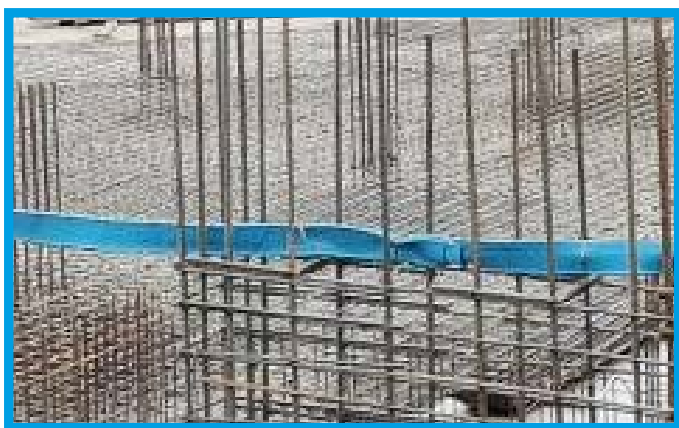
Рис. 10.3. Пример недопустимого соединения гидрошпонки встык без сварки (с реального строительного объекта в Москве).
