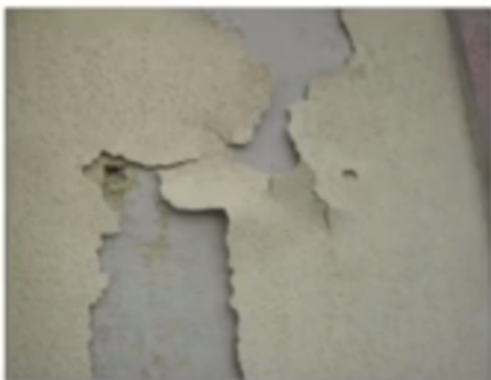
Гидроудар, акриловая штукатурка по каменной вате
