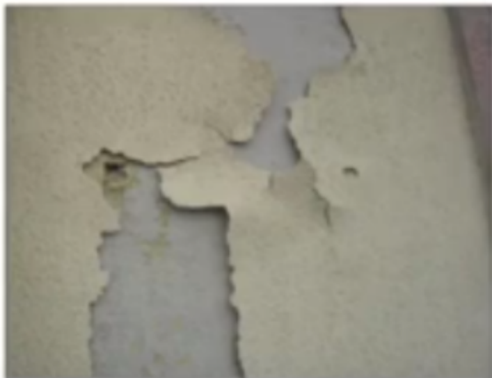
Гидроудар, акриловая штукатурка по каменной вате
