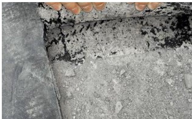
Рисунок 3.6. – Отсутствие адгезии материала к основанию из-за нанесения праймера на пыльную поверхность
