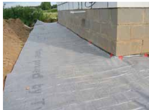
Дренаж в отмостке
